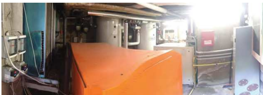
Figura 2 - Centrale termica Condominio Giadini Sud
