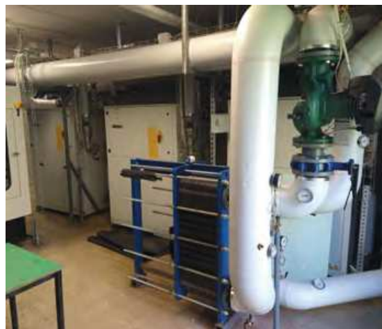
Figura 7 - Pompe di calore e cogeneratore
