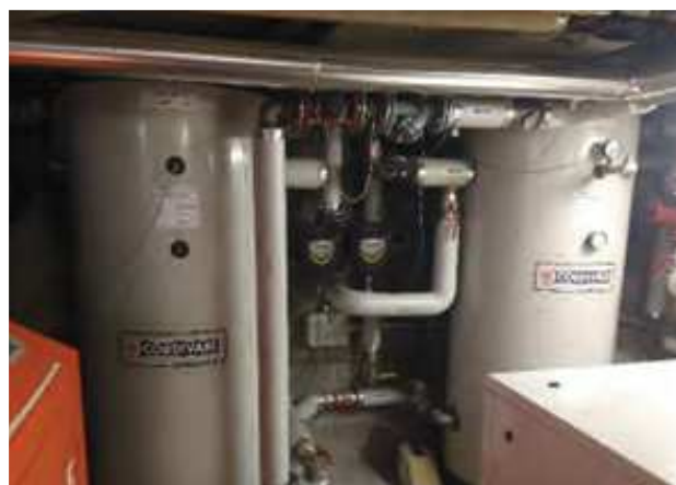
Figura 4 - Dettaglio serbatoi accumulo acqua tecnica
